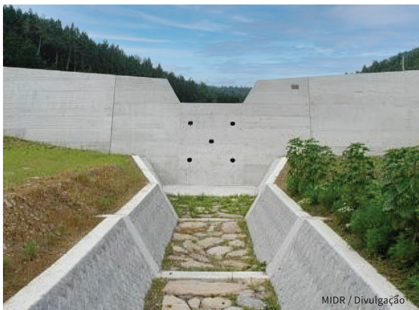
Modelo de barreira Sabo projetada para conter fluxo de detritos por deslizamentos de terra
