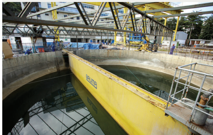
O poço da estação Gávea está sendo drenado. Foto: Divulgação/Setram-RJ
